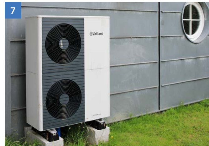
Abbildung 7: Wärmepumpe beim LKN.SH Meldorf, Nationalpark-Station Wattwurm.
