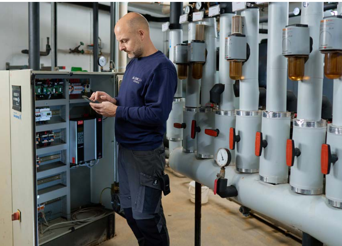
Abbildung 18: Zur nachhaltigen Gebäudebewirtschaftung zählt auch die digitale Ablesung von Heiz- und Stromdaten.
